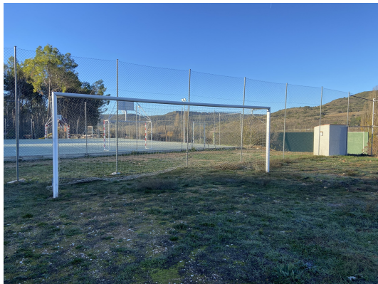
Porteria Sur y armario electrico
