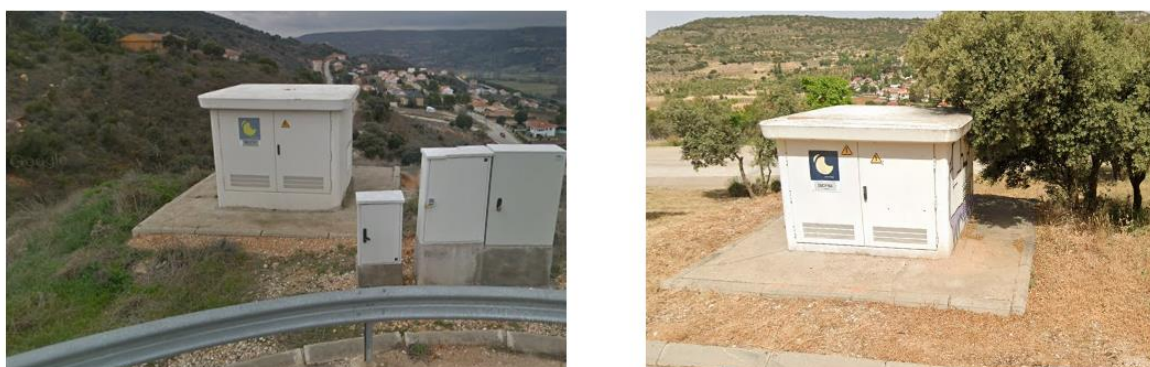
Figura 6. Centros de transformación en la urbanización Sierra de Tajuña, Ambite.
