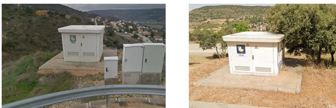
Figura 121. Centros de transformación en la urbanización Sierra de Tajuña. Ambite.
